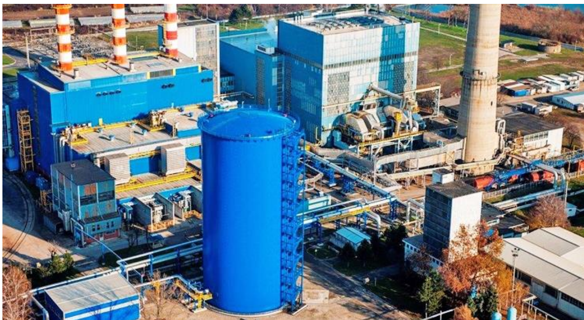
Slika 32. Akumulator topline, TE-TO Zagreb [49]
